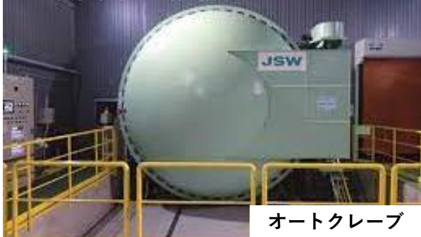
航空機複合材工場設備
