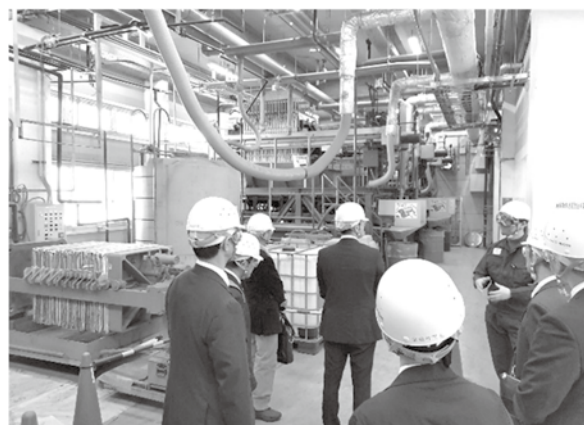
▲ 凝集沈殿処理
