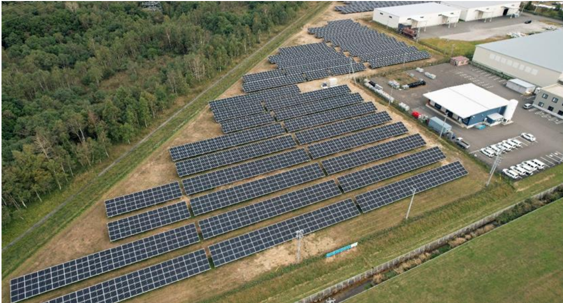
(写真:本事業の太陽光発電所)
