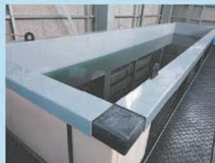
大型酸洗槽は 管長7mまで対応可能!!
