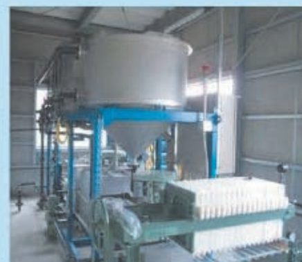
処理能力1日8m 3 を誇る 廃水処理設備を導入!
