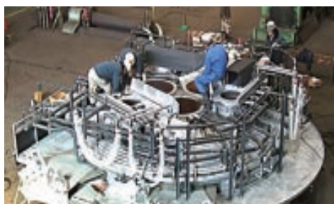
【鋼製 某製鉄メーカー向高炉設備】
