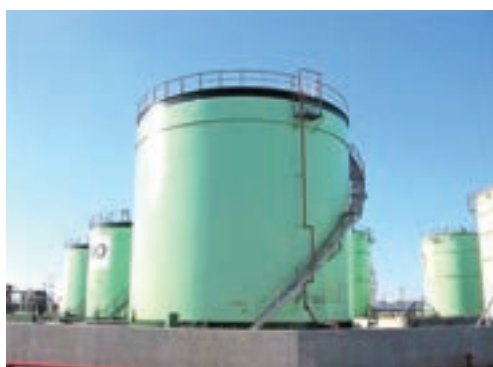
【鋼製オイルタンク】
